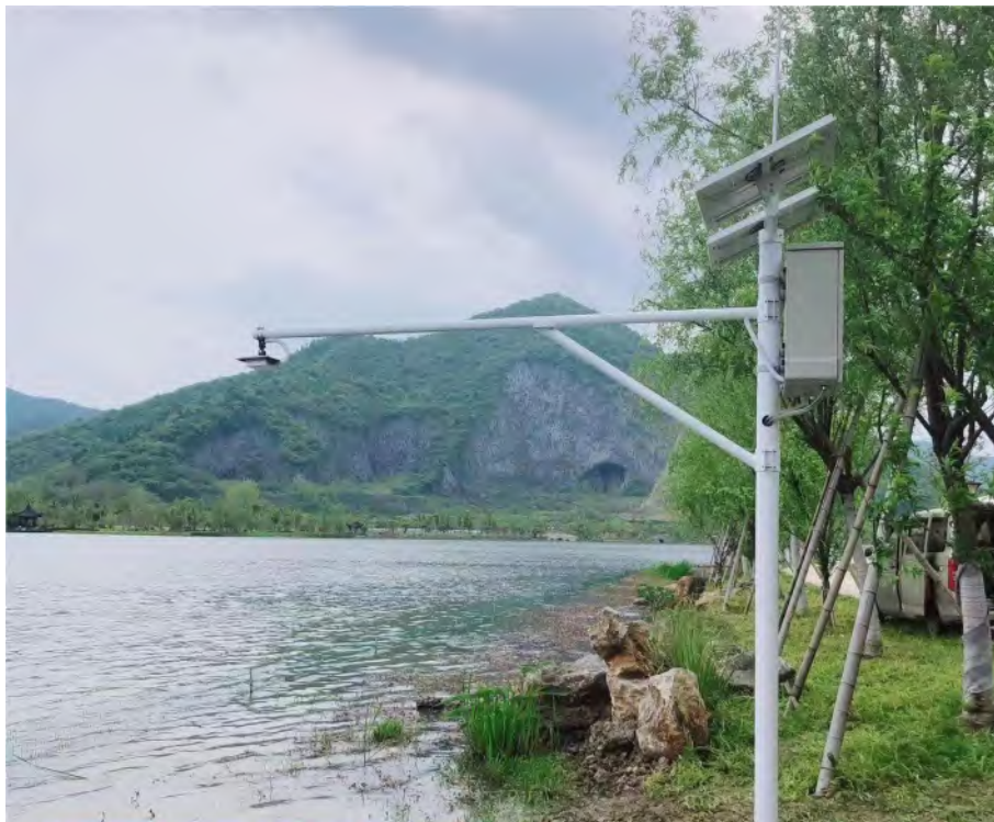
图 9-10 雷达式水位计立杆式安装现场图
