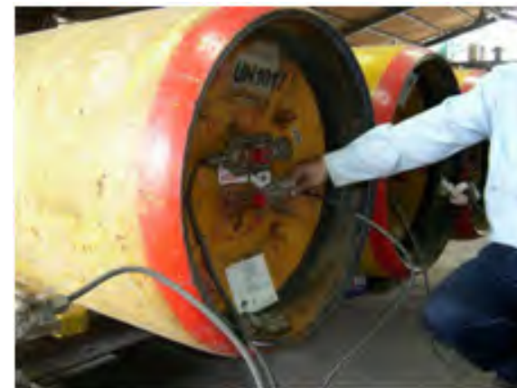
高壓氣體設備
