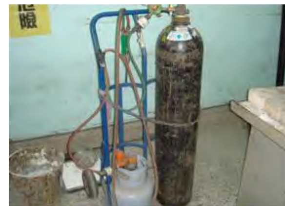
高壓氣體設備-鋼瓶
