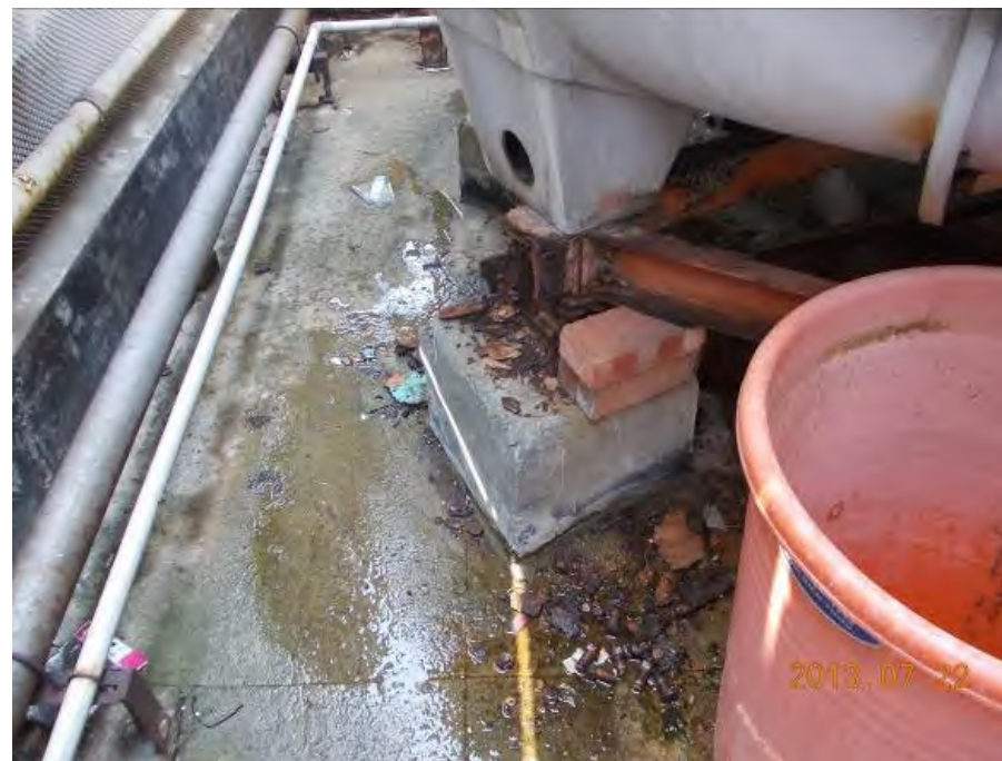
冷卻水塔漏水
