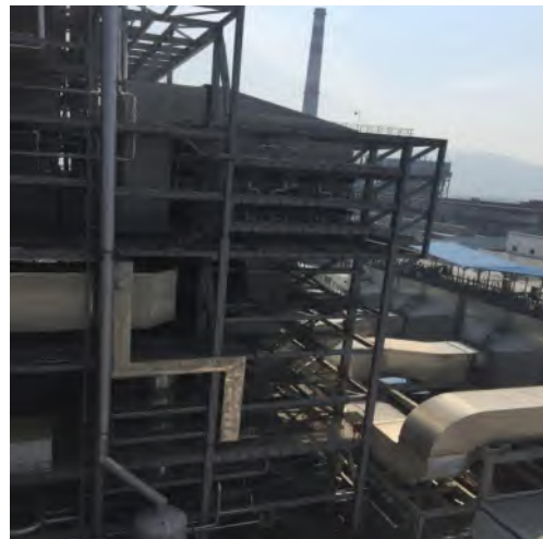
图 8-13 烟气脱硝全貌
