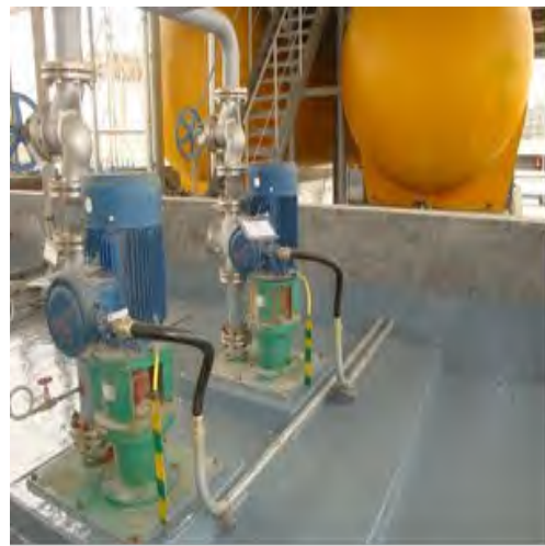
图 8-6 氨区废水池及废水提升泵
