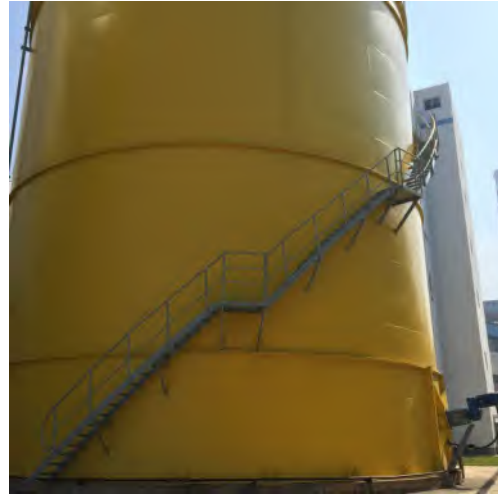
图 8-11 脱硫事故浆液箱
