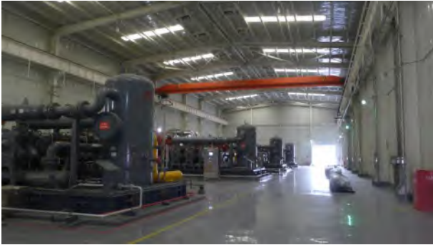
压缩机置于隔音室内
