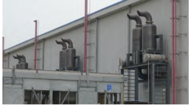
压缩机排气筒消声器
