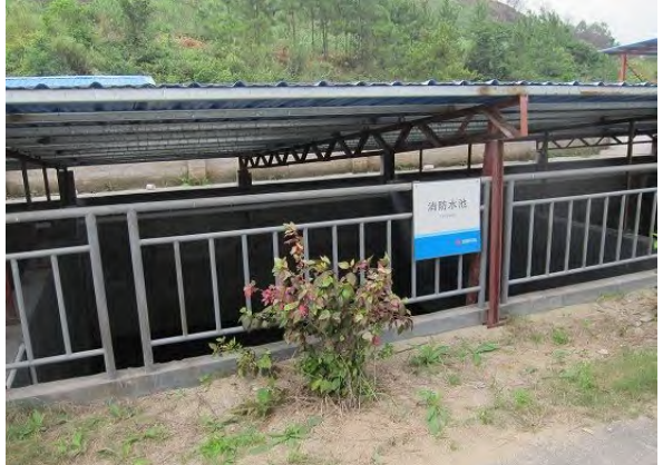
照片 7-33 消防废水池
