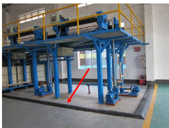
照片 7-17 污泥压滤区防泄漏围堰
