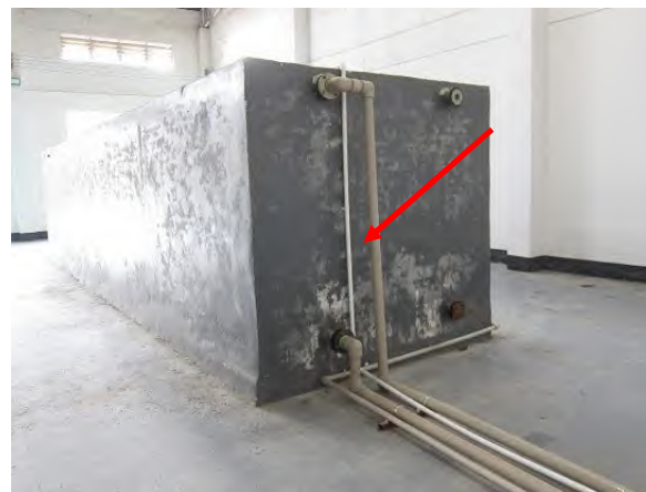
照片 7-8 初期雨水回用管道
