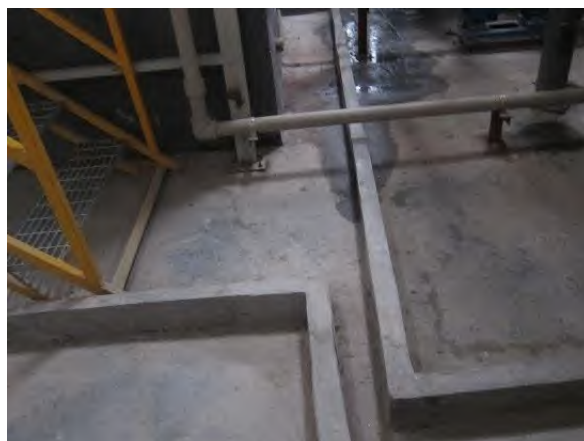
照片 7-16 无害化处理区防泄漏围堰
