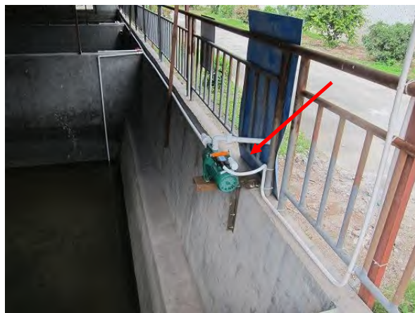
照片 7-7 初期雨水回用水泵
