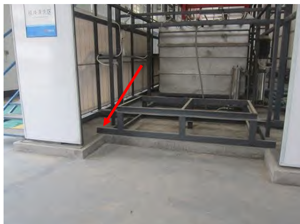
照片 7-15 清洗区防泄漏围堰
