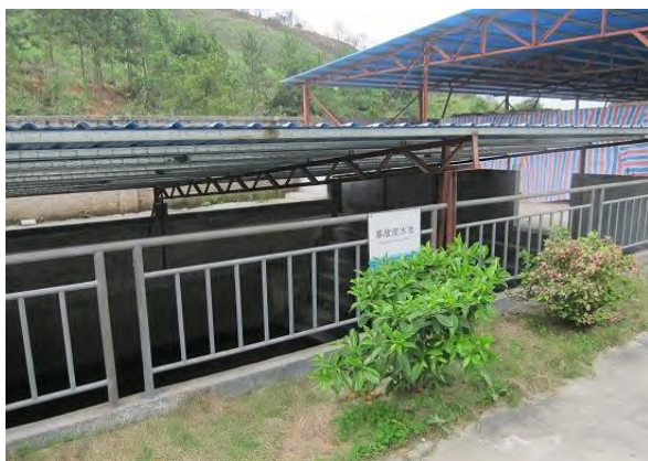
照片 7-32 事故废水收集池
