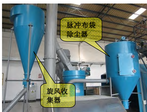
照片 3-7 废气处理设施
