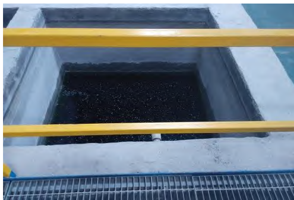
照片 7-25 再生利用浓水暂存池
