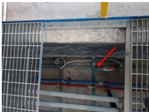
照片 7-5 沉淀池生产废水回用管道
