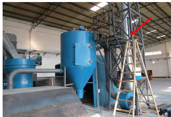
照片 7-29 废气排气筒监测平台
