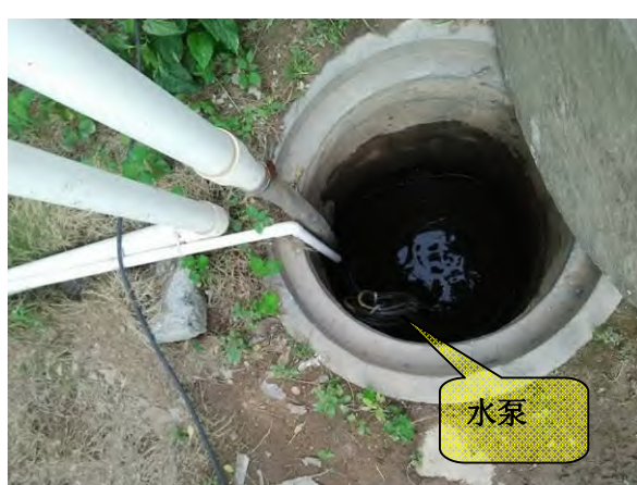
照片 3-5 初期雨水收集设施
