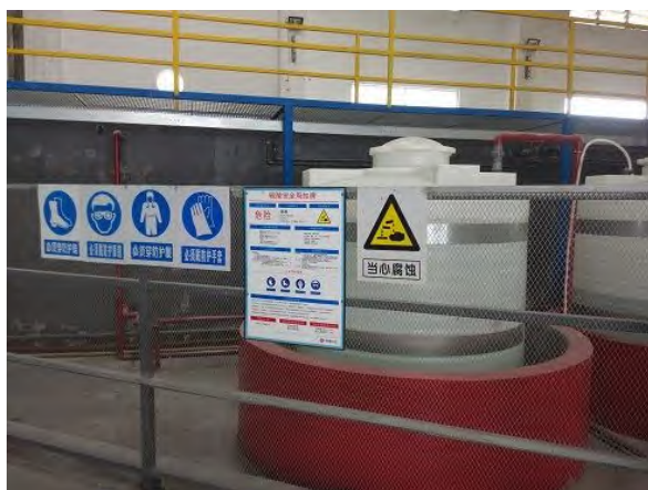
照片 7-24 废酸暂存罐
