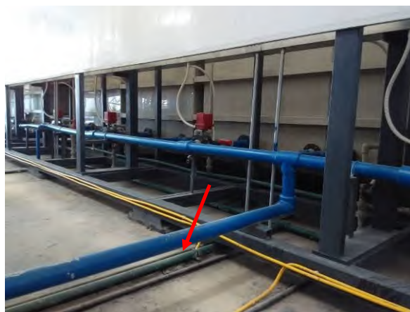
照片 7-6 清洗池生产废水回用管道
