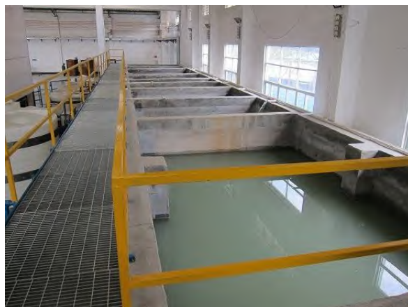
照片 3-2 生产废水沉淀池
