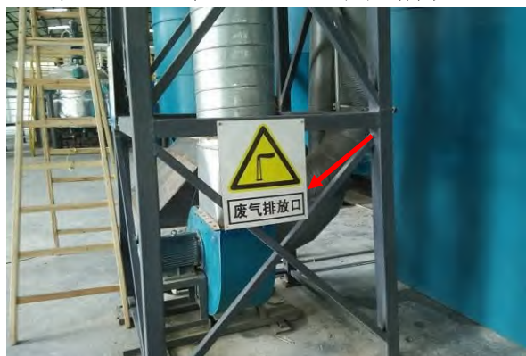
照片 7-28 废气排气筒标志牌
