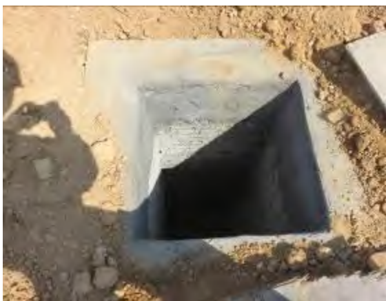
照片 8-4 雨水收集池
