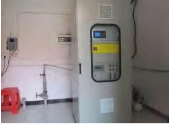
照片 9-21 烟气排放连续监测系统
