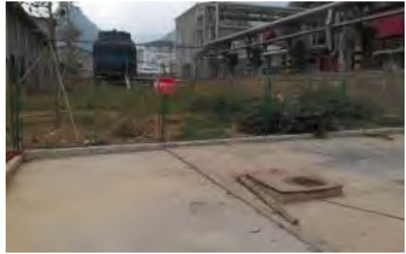
照片 9-14 氨水储罐事故应急池
