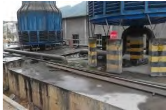
照片 9-16 循环水池
