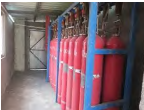
照片 9-12 煤磨系统自动灭火装置
