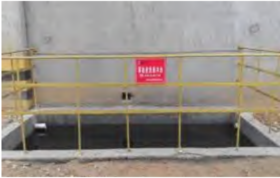
照片 9-13 煤磨系统消防废水收集池
