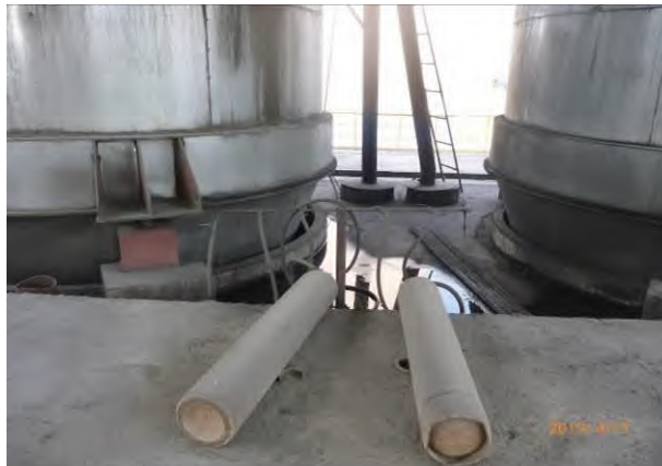
照片 9-13 CO 灭火装置
