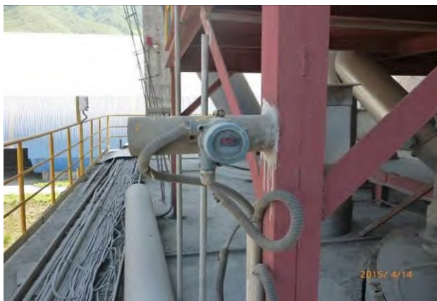
照片 9-12 煤粉仓测温装置
