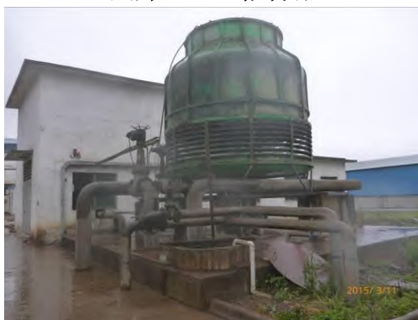
照片 9-17 循环水池
