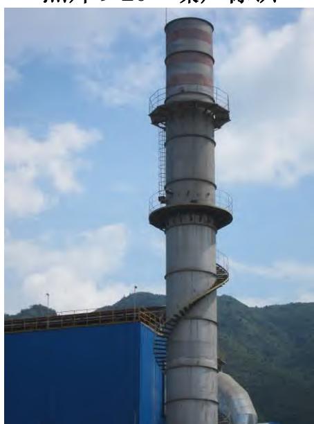
照片 9-22 规范化排气筒
