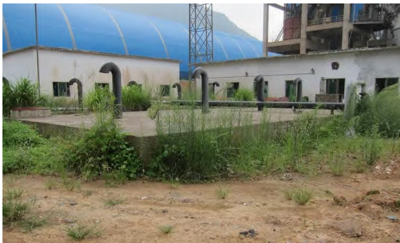
照片 9-18 消防水池
