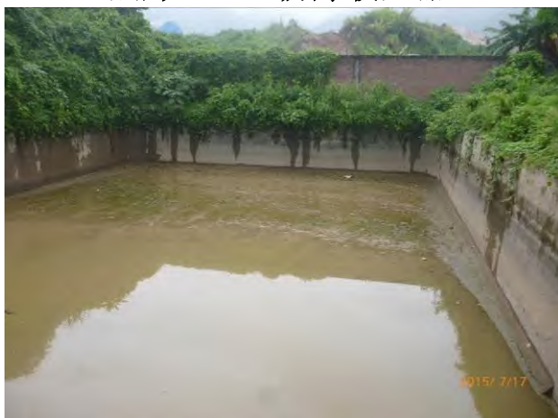
照片 9-16 应急和蓄水池
