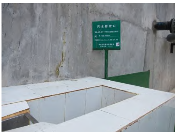
照片 9-48 废水排放口及标志牌
