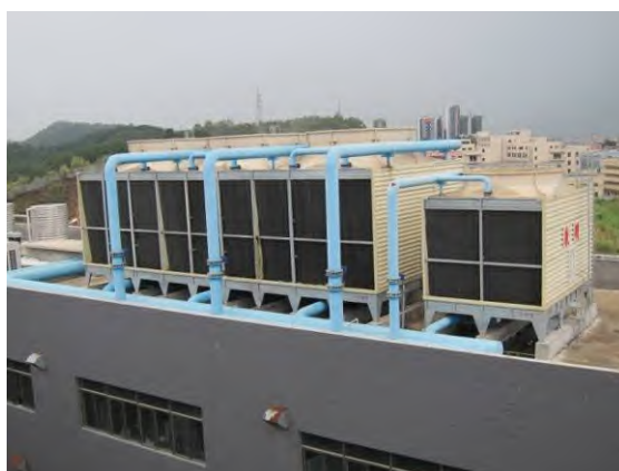
照片 9-65 冷却塔减振座及隔声措施
