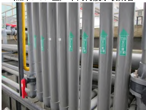
照片 9-58 污水处理站各类废水管道
