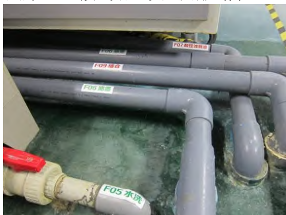
照片 9-56 生产车间内废水收集管
