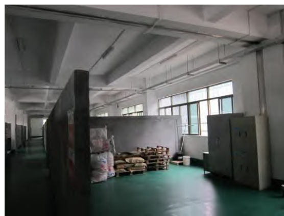
照片 9-63 危废贮存仓库防渗地面
