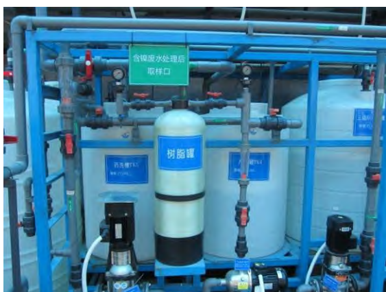
照片 9-66 含镍废水处理设施取样口
