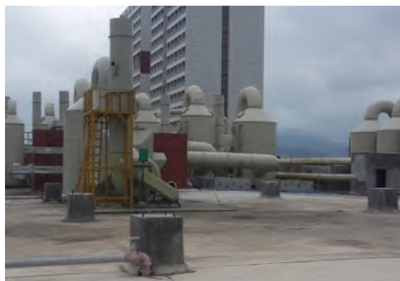
照片 9-55 废气治理设施及排气筒 (2)
