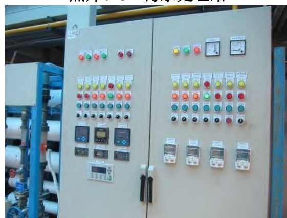
照片 9-59 污水处理站控制系统
