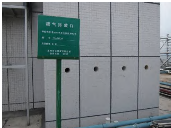
照片 9-49 废气排放口及标志牌
