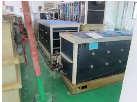
照片 9-45 碱性蚀刻液回收铜系统
