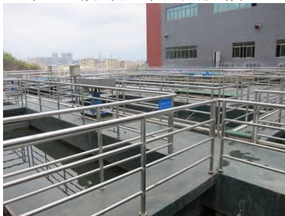
照片 9-57 污水处理站
