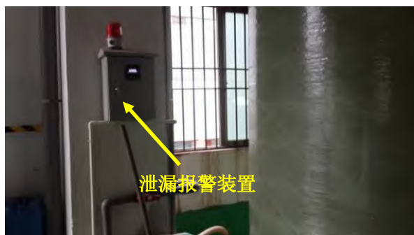
照片 9-32 液体储罐泄漏报警装置
