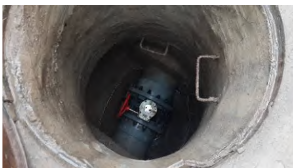
照片 9-28 厂区排口截断阀门
