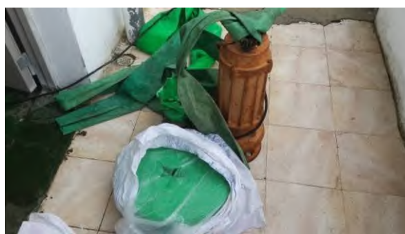
照片 9-29 备用潜水泵
