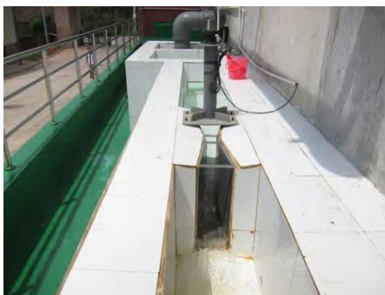
照片 9-67 废水总排口及在线监测探头
