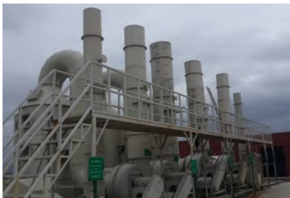
照片 9-54 废气治理设施及排气筒 (1)
