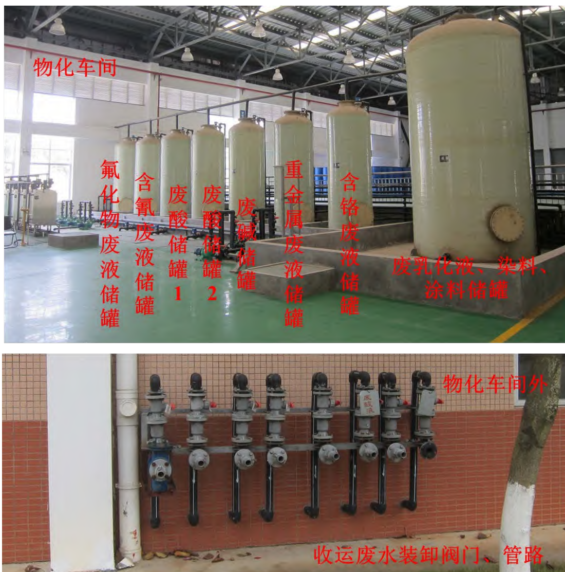
图 4-1 收运废水储罐
