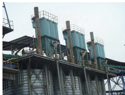
图 9-10 水泥散装系统除尘器
