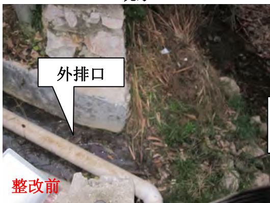
图 9-23 职工食堂厨余废水存在外排现象
