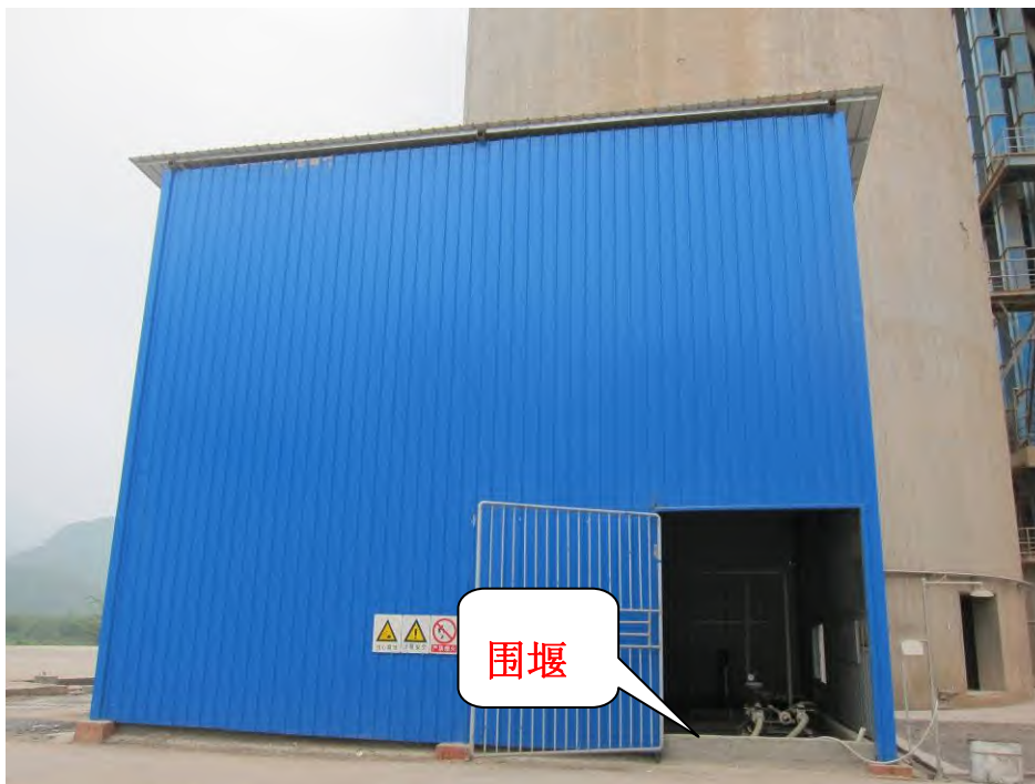
图 9-3 中源公司液氨罐区
