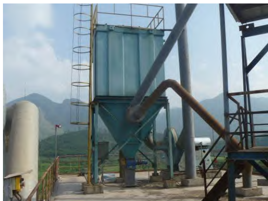
原料粉磨系统除尘器
