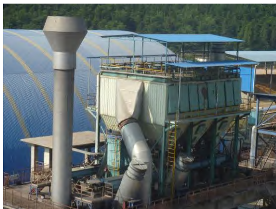
煤粉制备屋顶除尘器
