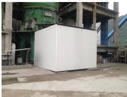
图 8-7 水泥立磨电机隔音板
