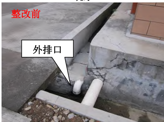
图 9-25 办公楼外存在外排现象
