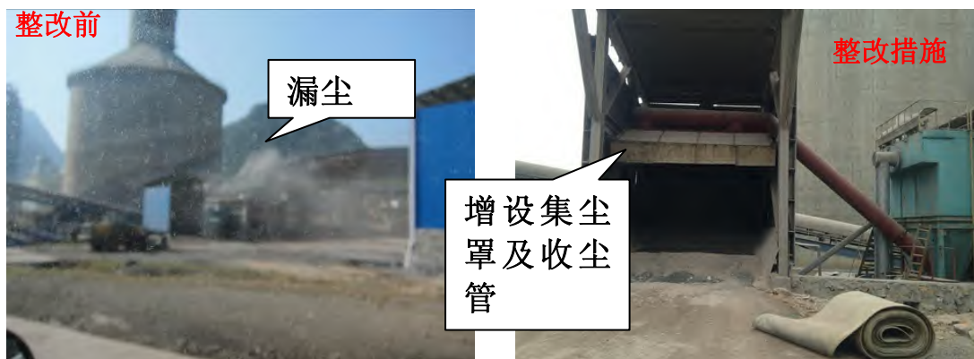
图 9-12 石膏破碎上料口漏尘
