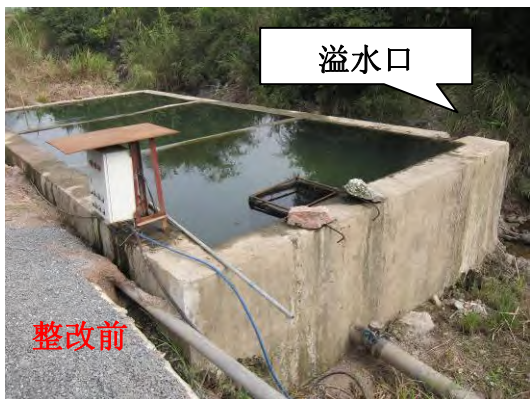
图 9-21 厂区内水池存在间断性溢水现象
