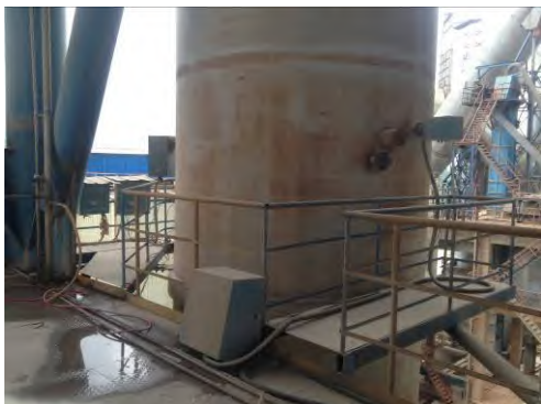
图 9-15 窑尾在线装置安装位置
