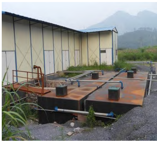
图 4-6 污水处理设施
