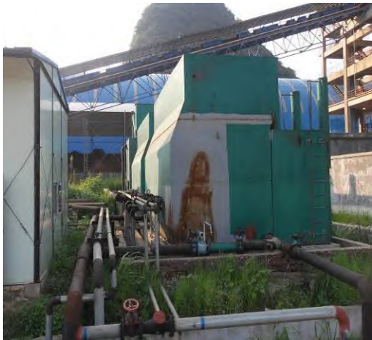
图 4-5 联合水泵站处理设施
