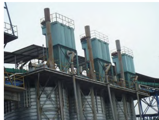
水泥散装库顶除尘器
