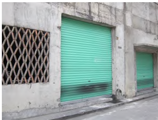
图 8-4 辊压机房隔音门
