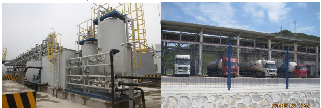
含油污水处理系统
