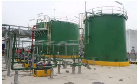
淡水及消防水罐
