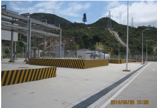
生产废水处理设备
