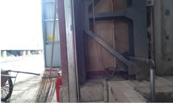
照片 9 污泥沉降池渗滤液抽水管
