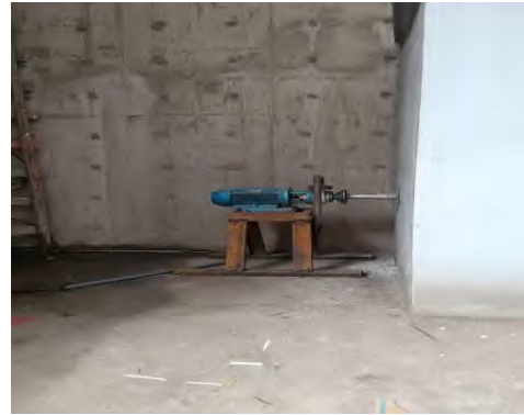
照片 10 渗滤液抽吸泵
