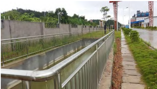
照片 11 厂区雨水收集池
