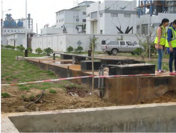
照片 14 污水处理设施
