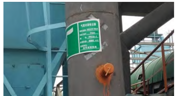
照片 6 原煤储运排口
