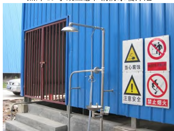
照片 21 罐区喷淋装置
