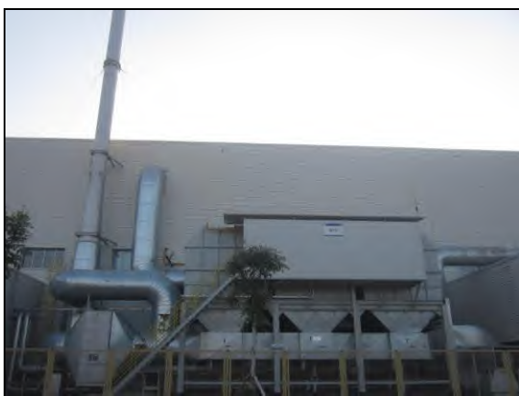
照片 9-1 涂装车间 RTO 炉
