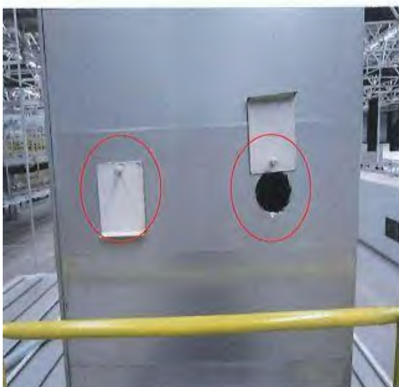
7.1、返修室（1）、（2）开孔 近景
