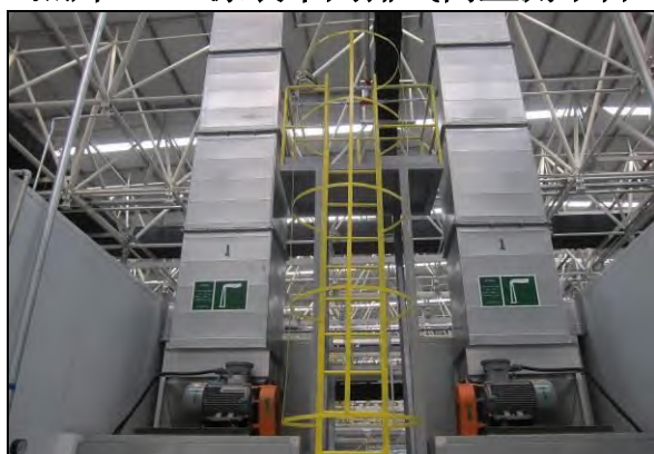
照片 9-32 总站车间废气排气筒
