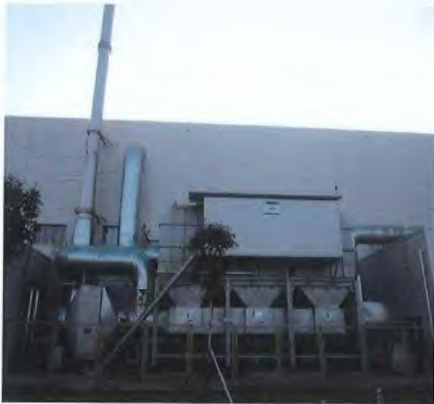
4.1、RTO 焚烧炉 远景
