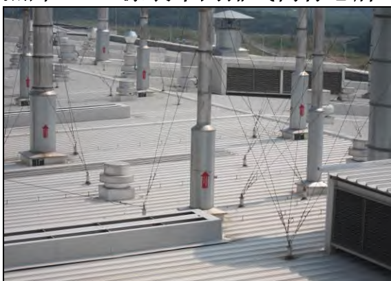
照片 9-31 涂装车间废气排放口
