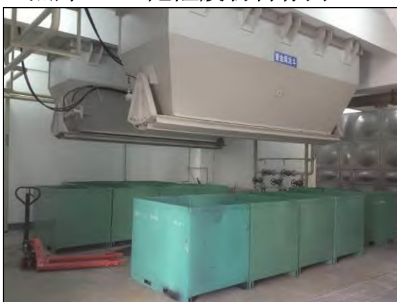
照片 9-23 污水处理站压滤污泥
