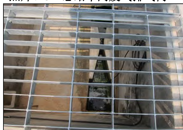
照片 9-34 废水排放槽
