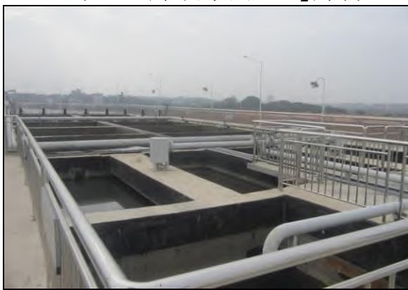
照片 9-7 污水处理站生化氧化池
