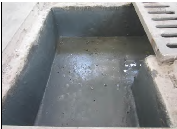
照片 9-51 废水站防腐防渗边沟
