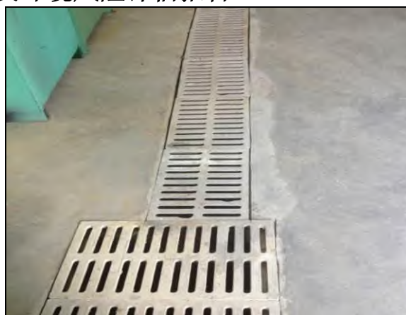
照片 9-42 污泥间截流沟
