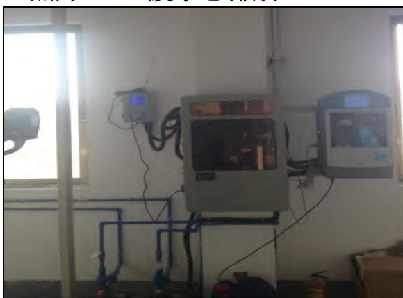
照片 9-35 废水在线监测仪
