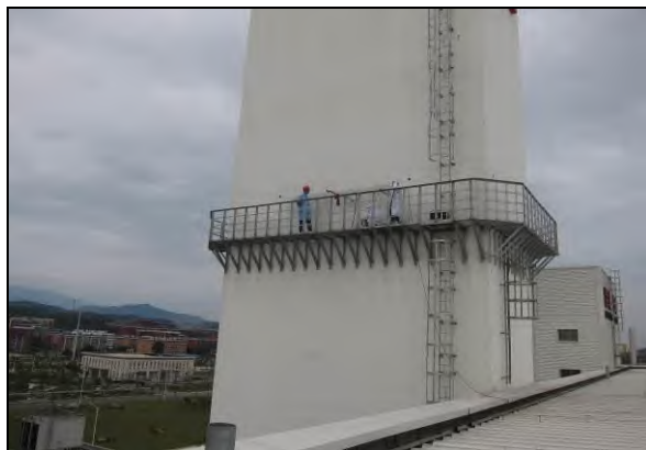
照片 9-30 涂装车间排气筒监测平台
