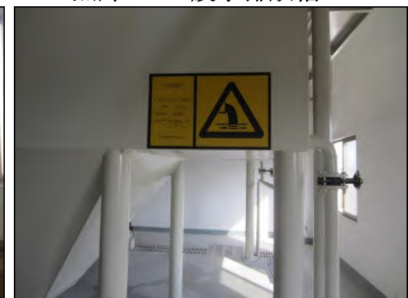
照片 9-36 含镍废水预处理排口标志牌
