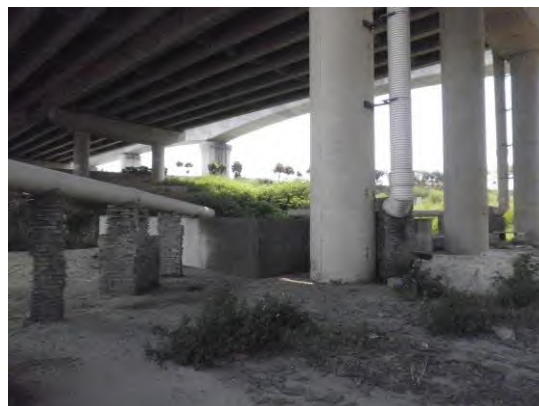
北江特大桥集水管+收集池
