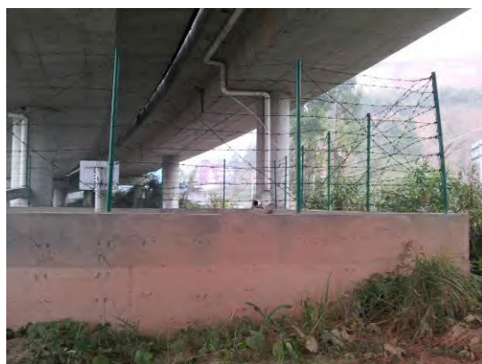
绥江官步大桥集水管+收集池
