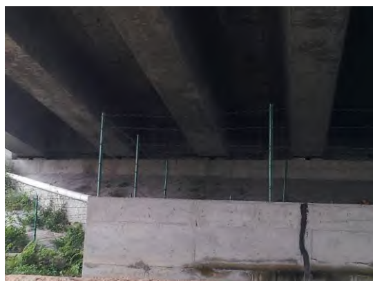
龙江大桥集水管+收集池
