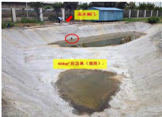
照片 7-11 现用 408m 3 应急池
