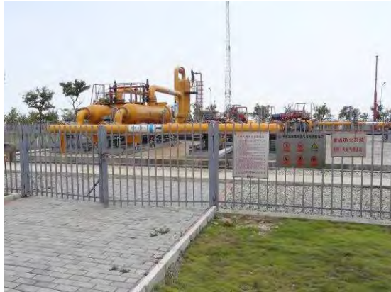
照片 7-9 天然气调压站
