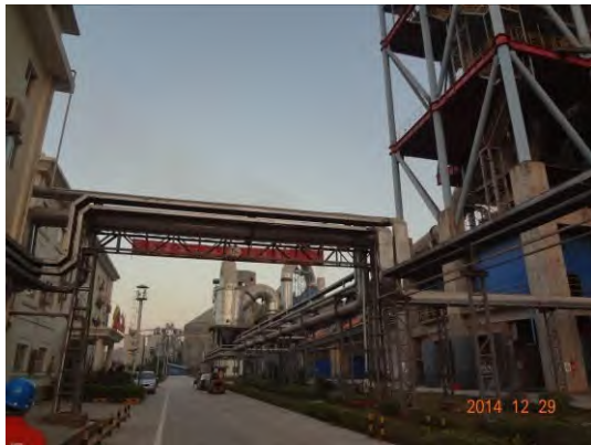
余热蒸汽输送管道
