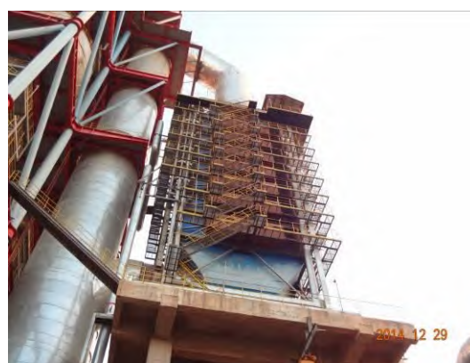
窑尾余热锅炉
