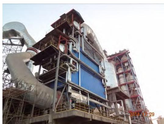
窑头余热锅炉
