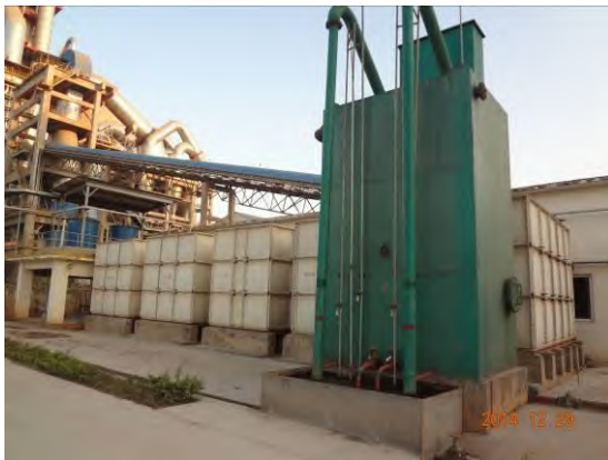
生产废水处理设施
