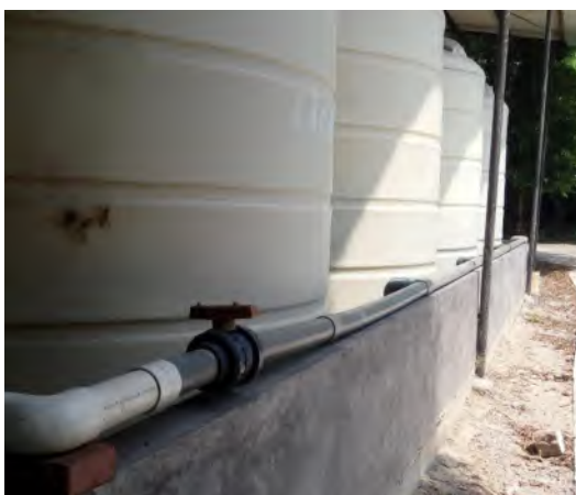
氨水存储区围堰
