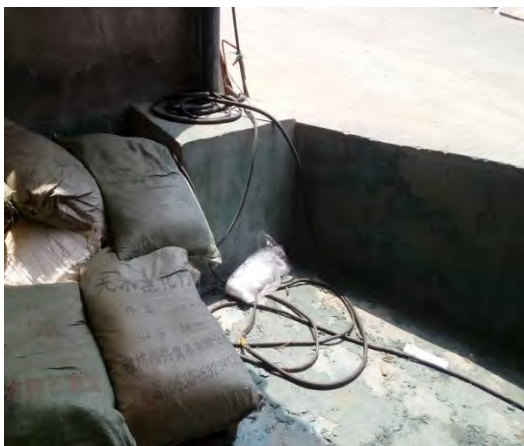
氢氧化钠储存区围堰
