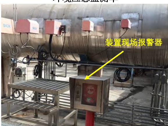
硫磺回收装置现场报警器
