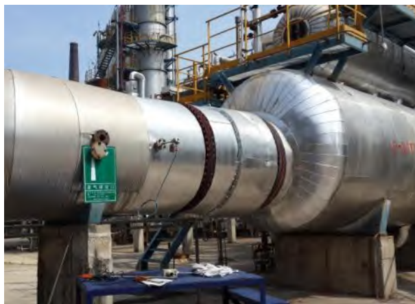
尾气焚烧炉及监测点位
