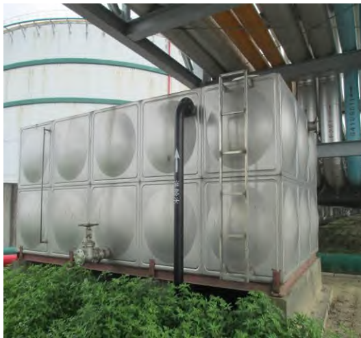
洗舱水暂存罐
