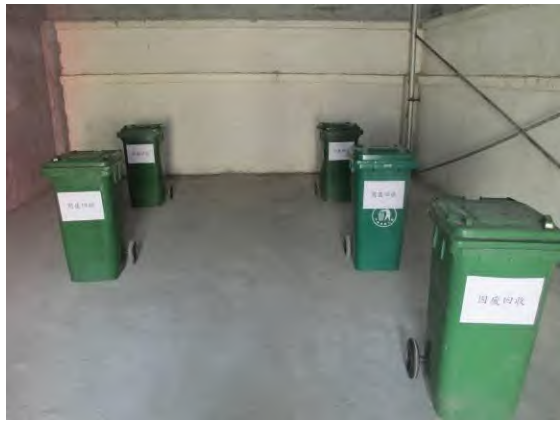
危废暂存库内部
