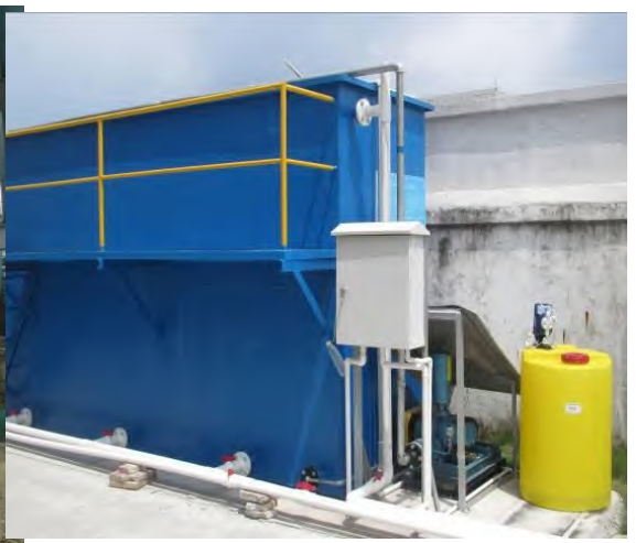
生活污水处理装置
