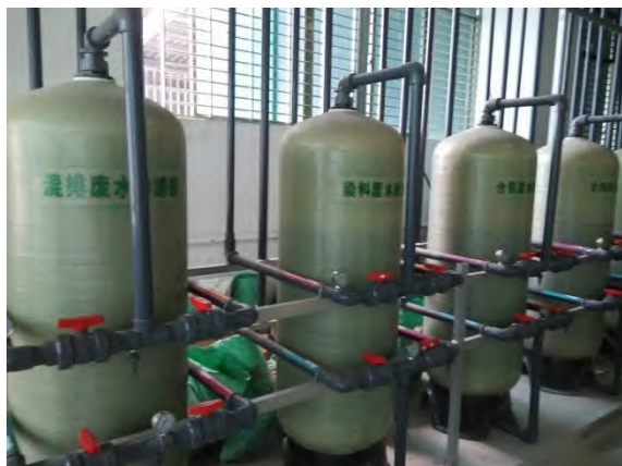
照片3-4 废水砂滤罐
