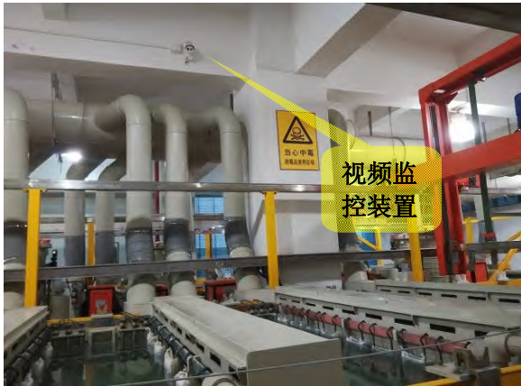
照片 7-23 氰化物使用区域视频监控
