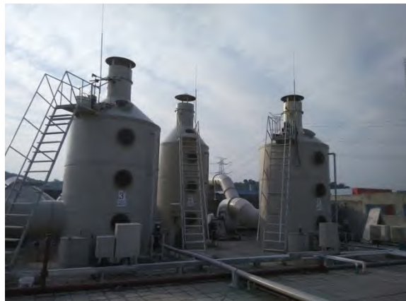
照片 3-10 氯化氢及硫酸雾废气吸收塔
