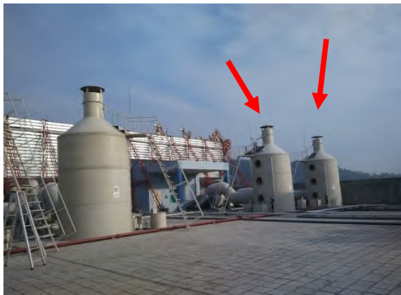
照片 3-9 氰化氢废气吸收塔
