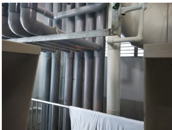
照片3-2 车间废水收集管道
