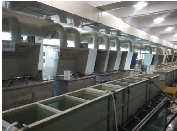
照片 3-8 电子配件电镀废气收集情况
