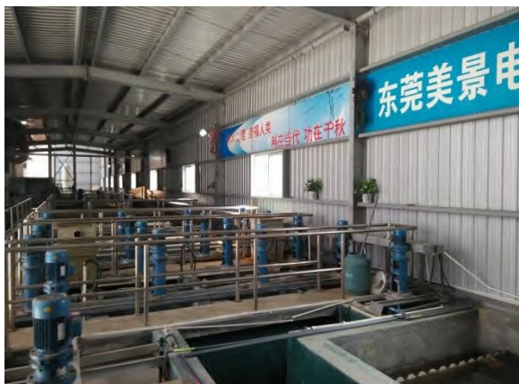
照片3-3 废水反应池和沉淀池
