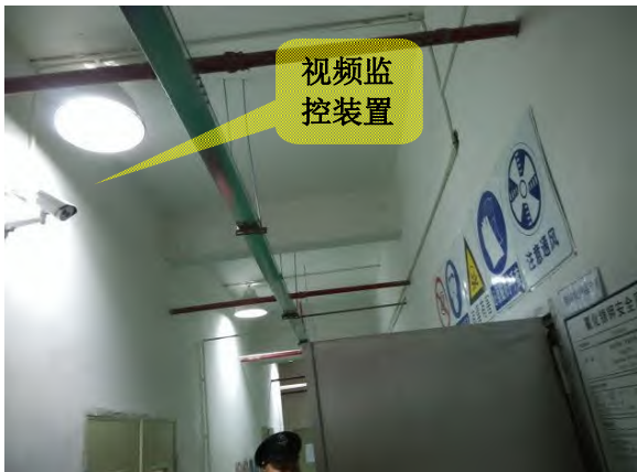
照片 7-25 剧毒化学品仓视频监控
