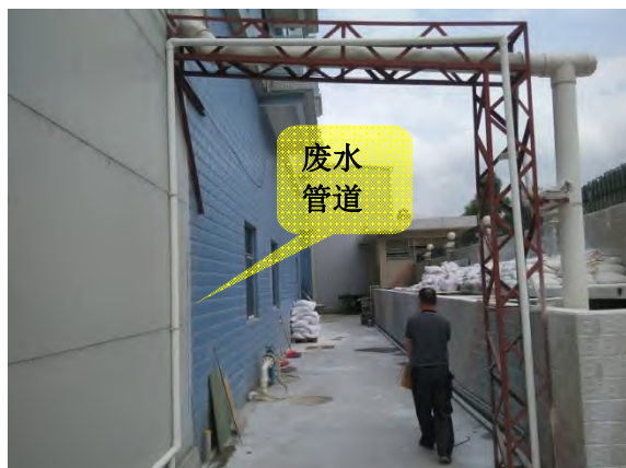
照片 6-2 研磨车间废水管道
