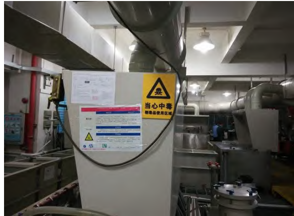
照片 7-22 氰化物使用区域警示牌
