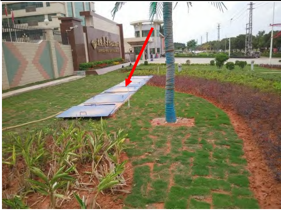
照片 7-19 废水事故应急池
