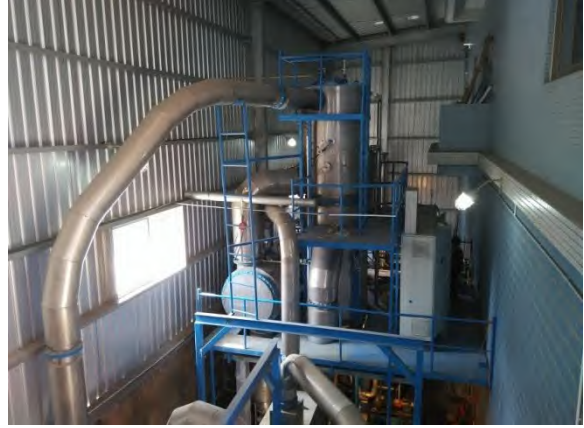
照片3-6 残余液蒸发器
