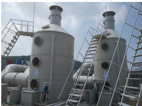
照片 7-13 废气监测平台
