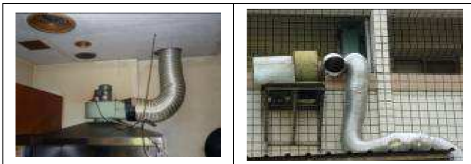
圖 14 常見廚房抽油煙機及管線
