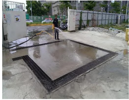
(H) 洗車廢水收集設施 (二)
