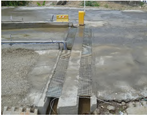
(G) 洗車廢水收集設施 (一)
