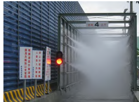
自動洗車設備(設置紅綠燈管制)
