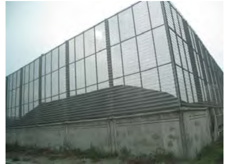
阻隔設備及防溢座
