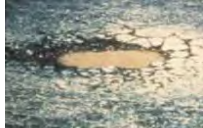
c) 重度坑槽
