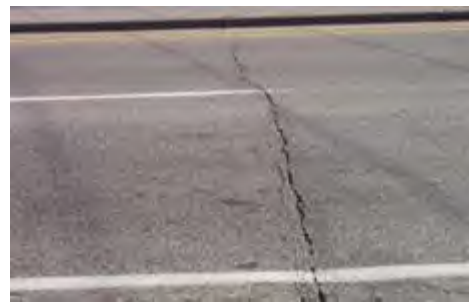
c) 重度横向裂缝
