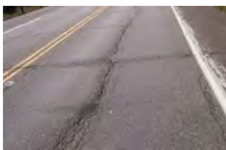
c) 重度纵向裂缝
