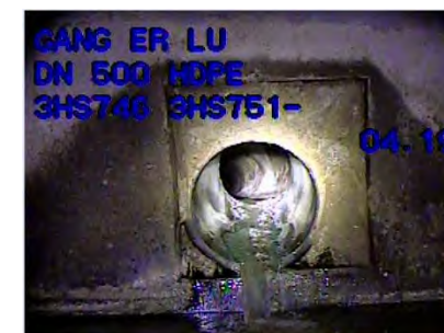
污水私接：港二路
