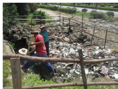
上金龙村口管涵堵塞情况
