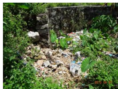
过路管涵崩塌淤积
