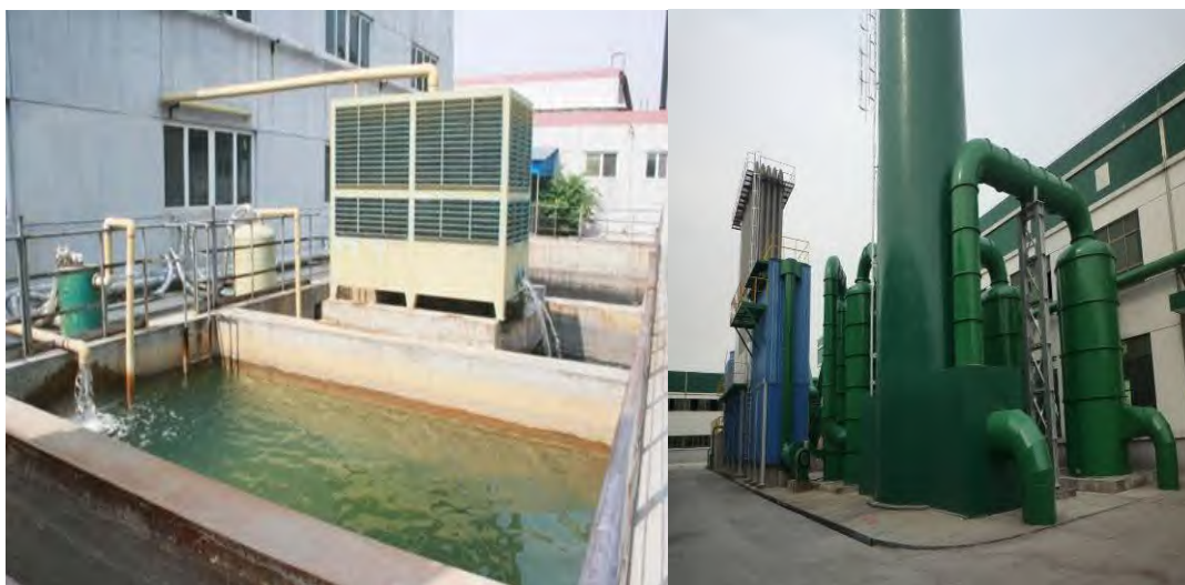
图 16 废水及废气处理装置
