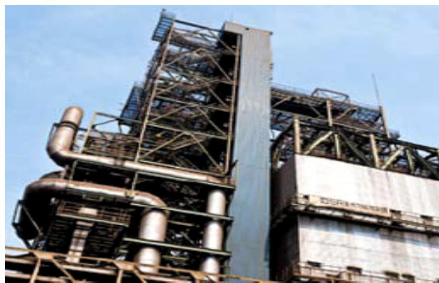
照片 2.5-2 烧成炉废气处理设备(出处:J 公司环境报告 HP)
