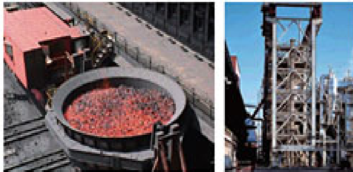
照片 2.5-1 新设节能形 CDQ 的事例 (出处:J 公司环境报告 HP)
