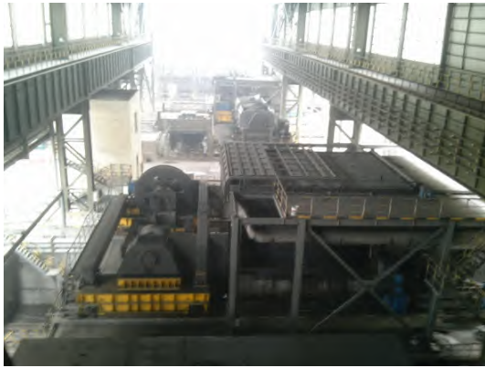
济源钢厂有压热闷生产线
