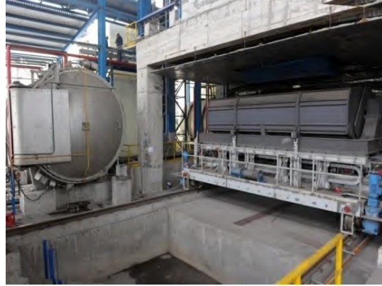
珠海粤裕丰钢厂有压热闷生产线
