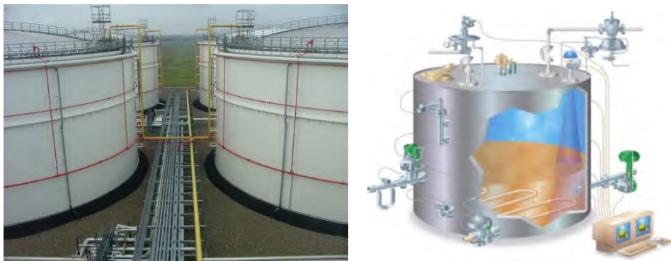
图 17 呼吸气收集系统（左：收集管线，右：调压和安全系统）
