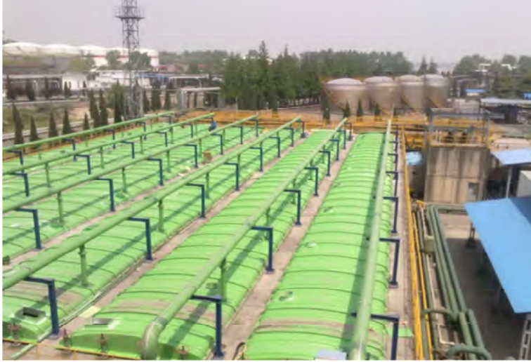
图 19 废水处理设施加盖密闭
